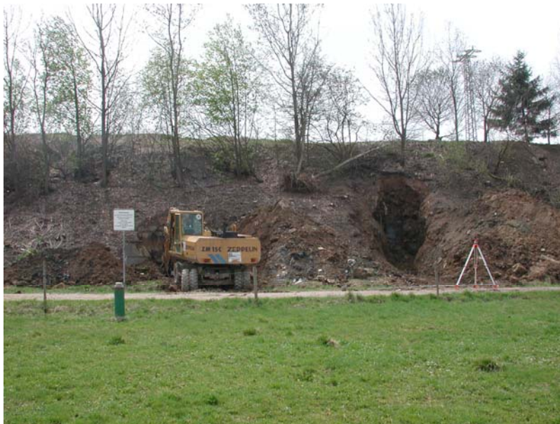
Ehem. Deponie Haldenstraße, Erkundung von Sickerwasseraustritten am Böschungsfuß
